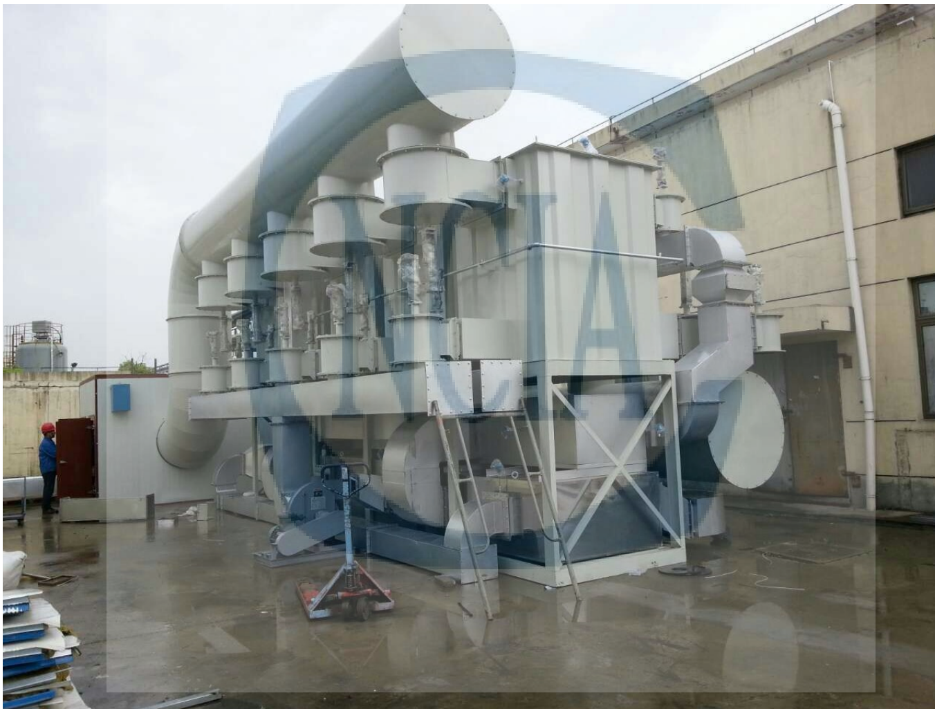
活性炭吸附+催化燃烧（CO）工程实例
